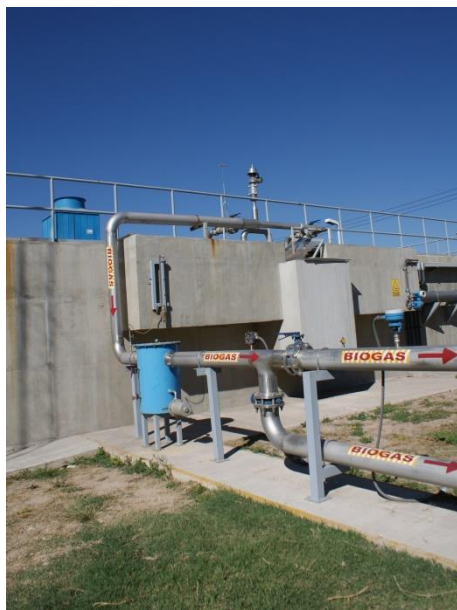
Línes for biogas
