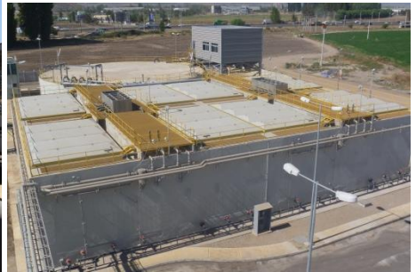
Reactores anaerobios UASB
