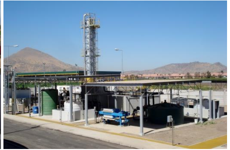
Sistema para lavado de biogás
