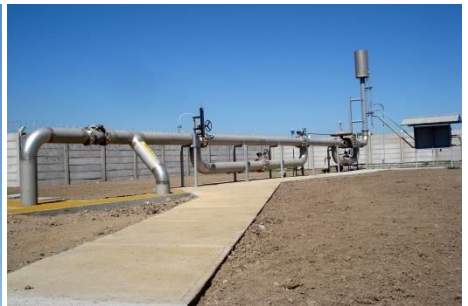
Sistema para quemado de biogás
