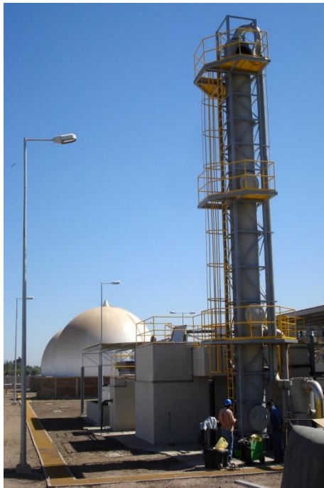
Sistema para lavado de biogás
